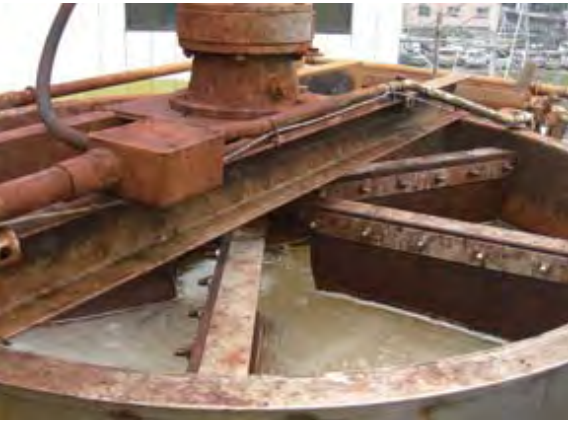
写真 -2 加圧浮上装置
