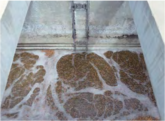
写真 -1 調整槽のばっ気状況
